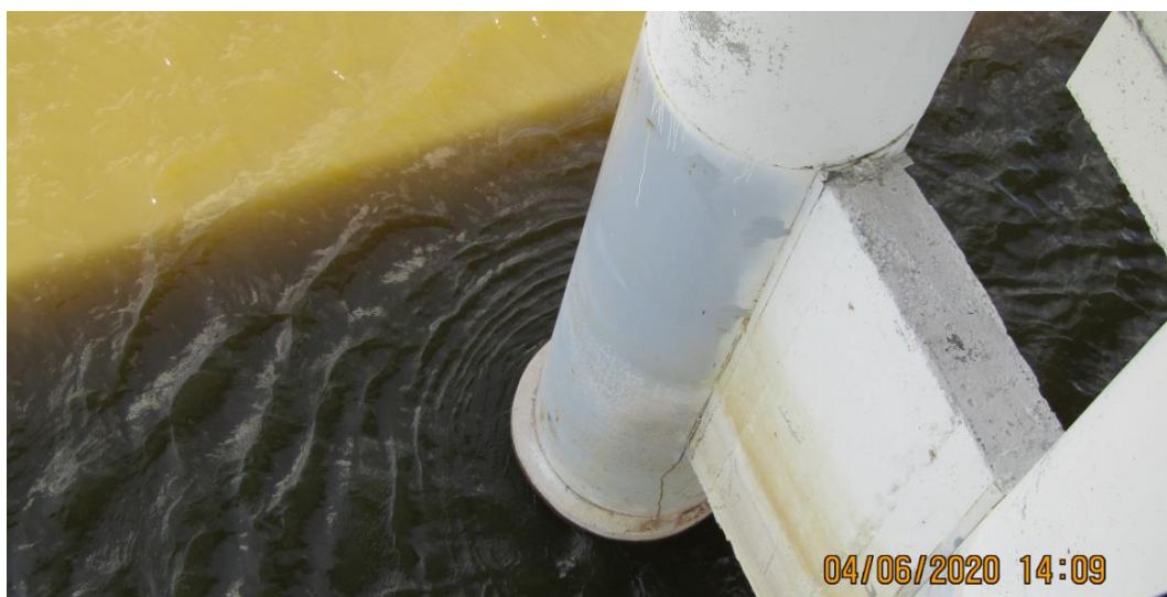
Рис. 1. Вертикальные трещины на опоре автодорожного моста
