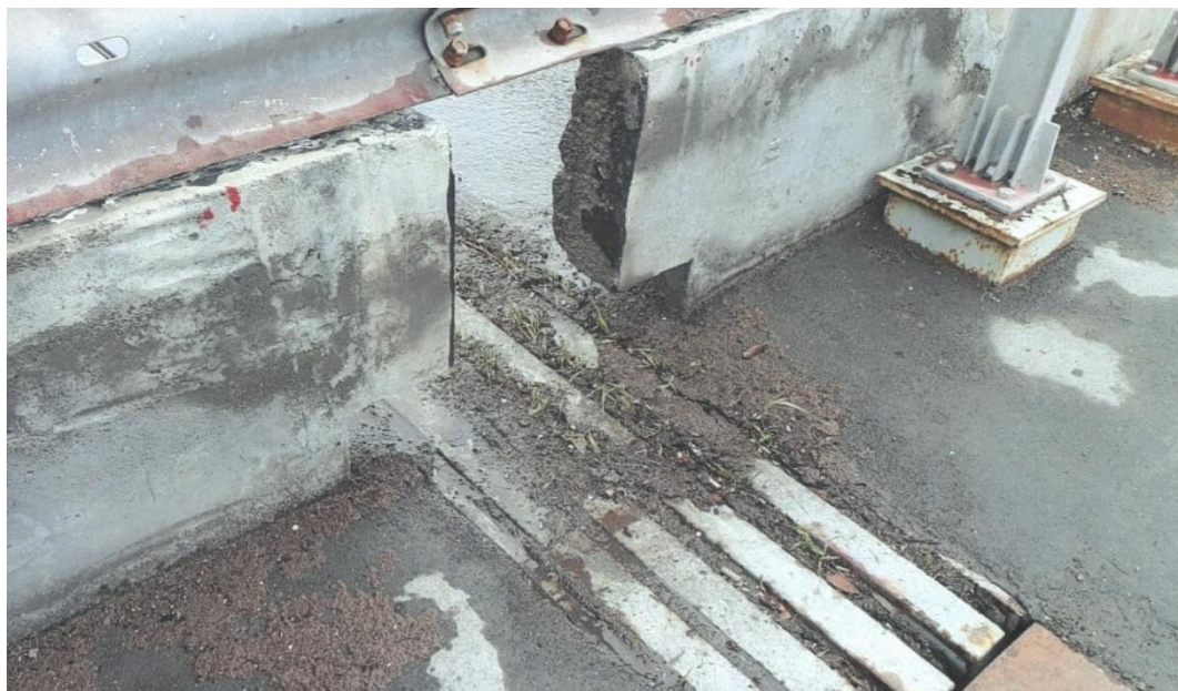
Рис. 3. Нарушение правил содержания деформационного шва моста
