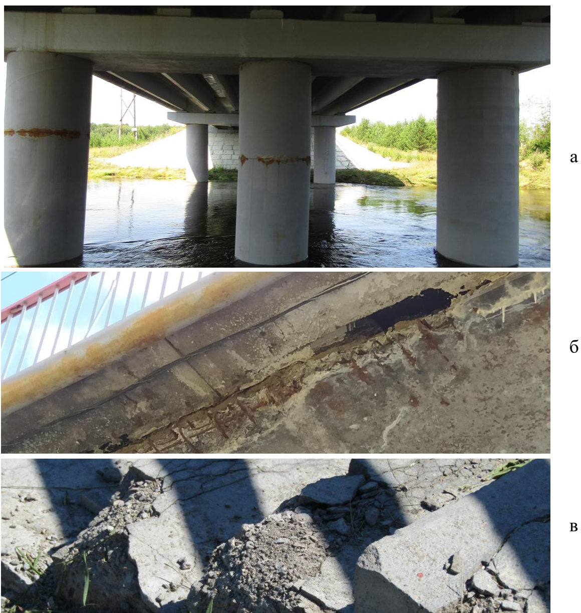
Рис. 1. Примеры разрушений бетонных и железобетонных конструкций автомобильного моста: трещины на промежуточных опорах (а); разрушение консольных тротуарных блоков (б); разрушение бетона лестничных сходов (в)
