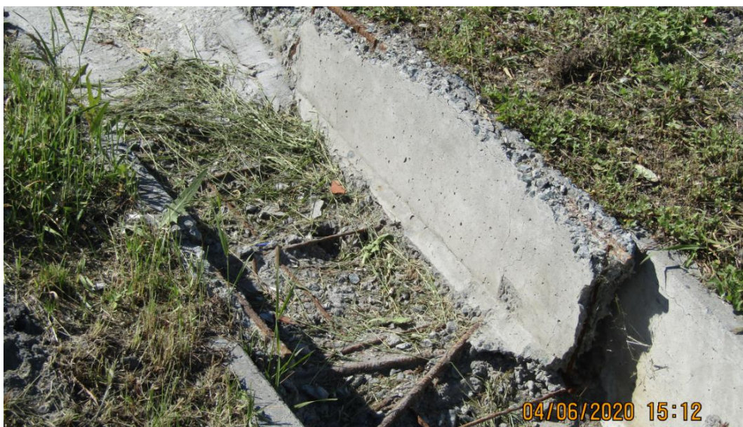
Рис. 2. Разрушение железобетона телескопического лотка
