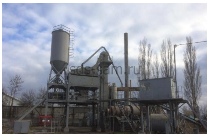
Рис. 2. Устаревшая асфальто-смесительная установка ДС-158, требующая модернизации
