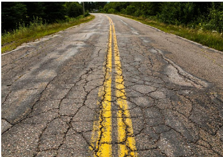
Рис. 2. Состояние покрытия дороги
