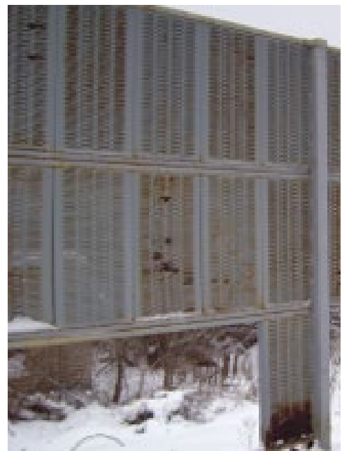
Рис. 3. Дефекты шумозащитных экранов
