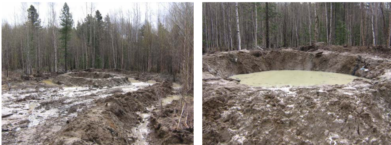
Рис. 4.11. Шламовый амбар с отсутствующей гидроизоляцией.
