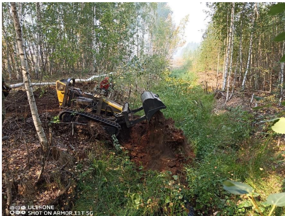
Рис. 4.24. Создание временной земляной перемычки на осушительном канале с применением радиоуправляемого гусеничного трактора на базе роботизированной платформы RoboGreen
